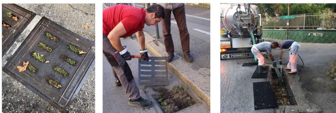
Figura 2. Manutenzione di caditoie saturate di sedimenti e rifiuti
