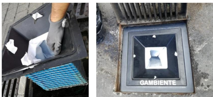
Figura 5. Posizionamento di un sistema GRIDD all'interno di una caditoia.
